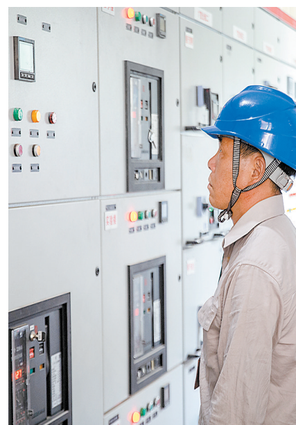
江南供电所工作人员检查考点配电房
