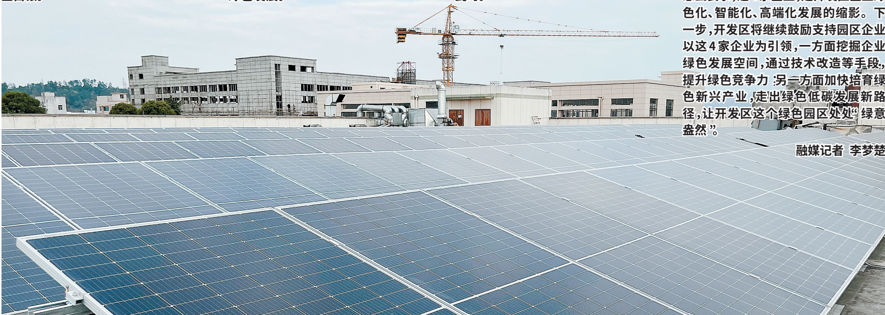
哈尔斯公司厂房屋顶铺满光伏发电板
