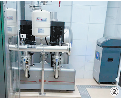
①②世纪华城小区二次供水设施改造前后对比，安防报警等功能，人防、物防、技防均按标准设置。
