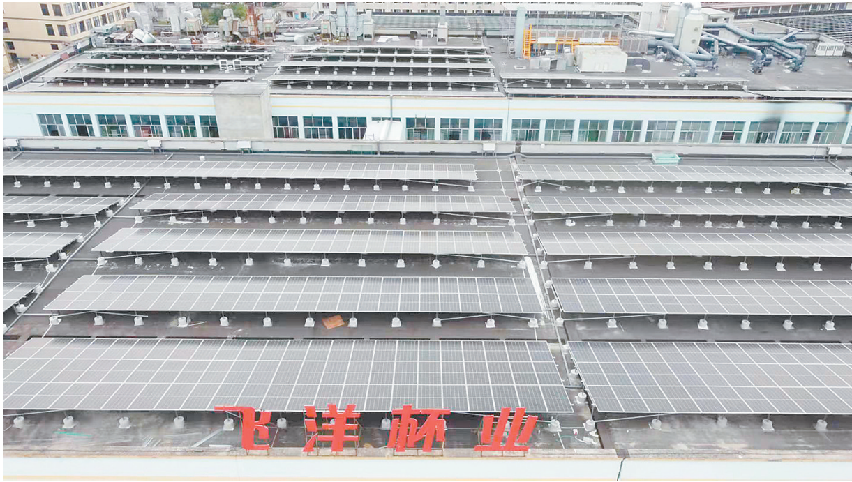
飞洋公司厂房屋顶的光伏设备
