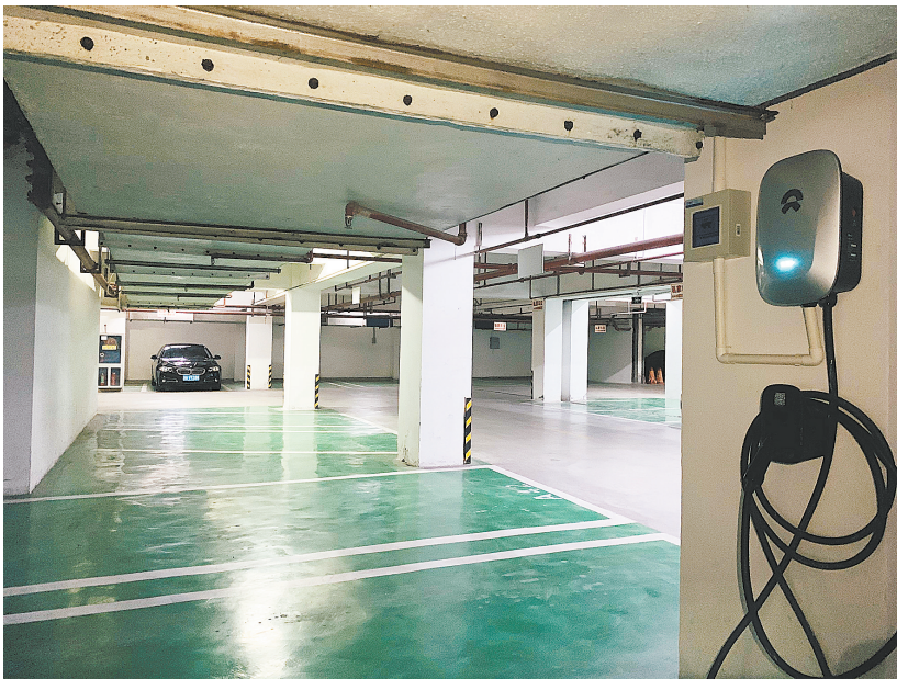
香格里拉城市花园小区地下车库已经安装的充电桩
