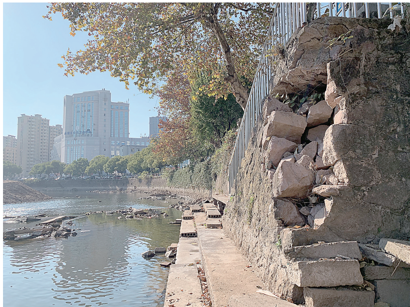
损坏的台阶基石
