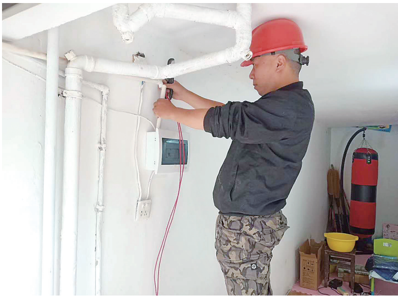
凌师傅在检修电路
