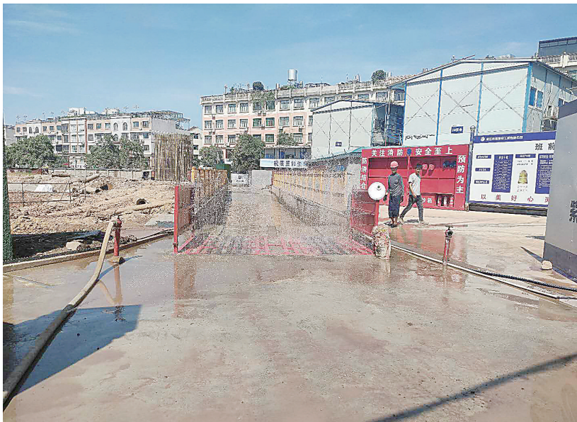
工地门口的冲洗设施
