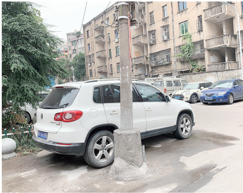
通信杆底部已经用水泥加固
