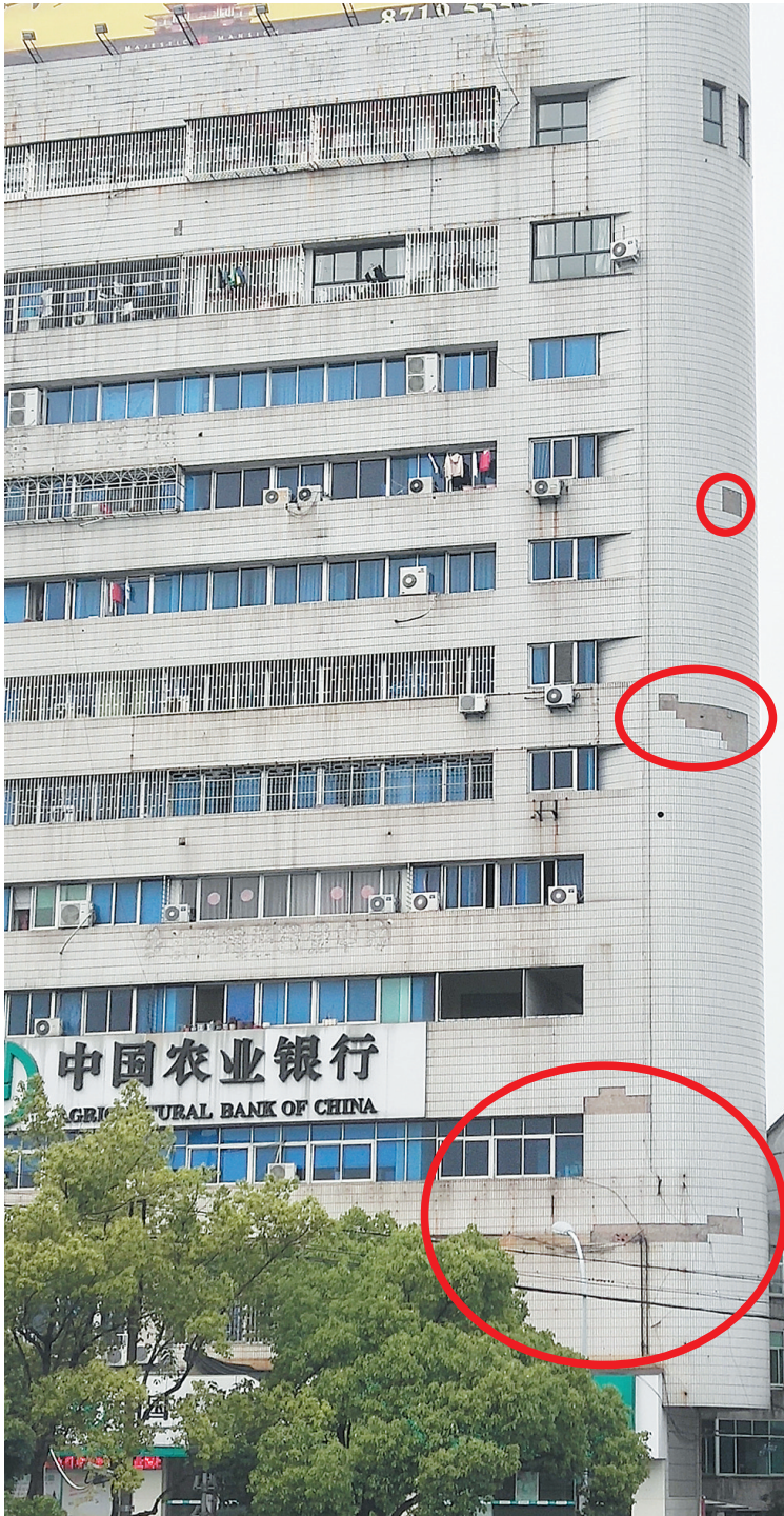
乡镇企业大厦外墙砖脱落明显
